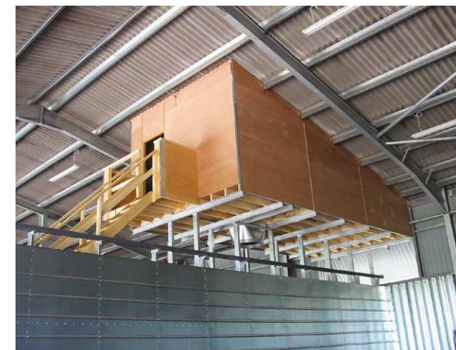
High level fan room
